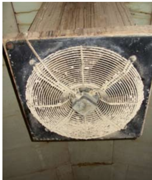
Bild 1: Neben der Laufzeit eines Motors hat z.B. bei Lüftern die Wartung einen großen Einfluss auf den Stromverbrauch.
